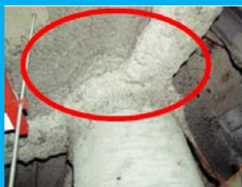
吹付け石綿 (レベル1)
